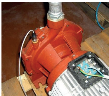
Obrázek 5: Příklad nasávacího otvoru na výtlačku čerpadla s připevněným snímačem
